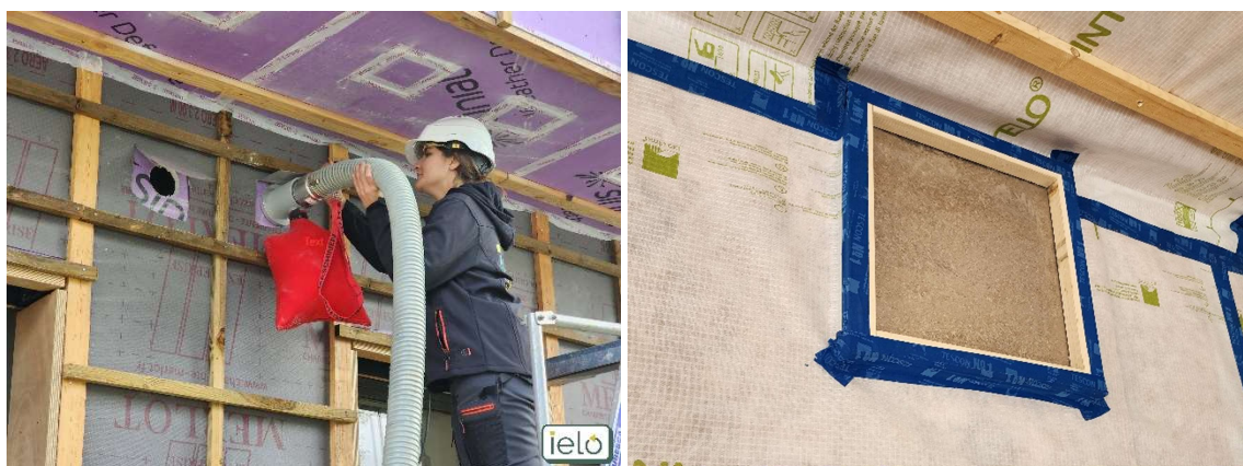
Figure 9 : Insufflation de paille hachée et fenêtre de vérité pour visualiser le bon remplissage, IELO
