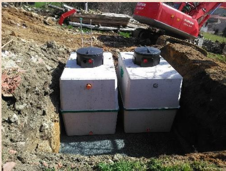
← Les cuves enterrées
